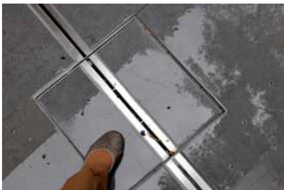
Odvodnění terasy rodinného domu v Klánovicích s nerezovým štěrbinovým žlabem MEA Nerez R'4200
