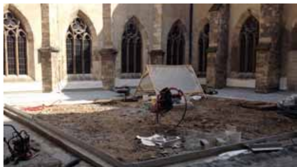
Odvodnění rajske zahrady v Emauzích nerezovým štěrbinovým žlabem
