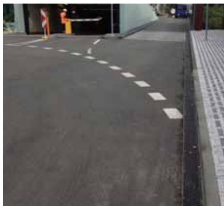
Žlab MEARIN 100 podél vozovky
